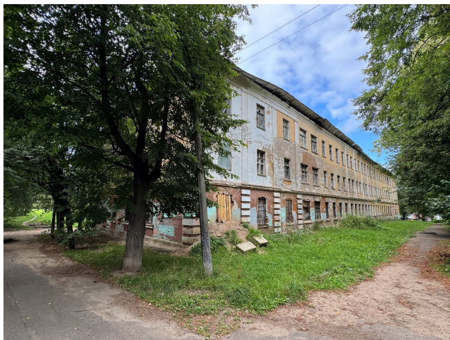
Рис. 1. Здание бывшего лагерного лазарета в аварийном состоянии. 24.08.2025 [Фото автора]
